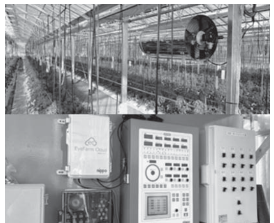
実証調査に用いた環境制御機器
