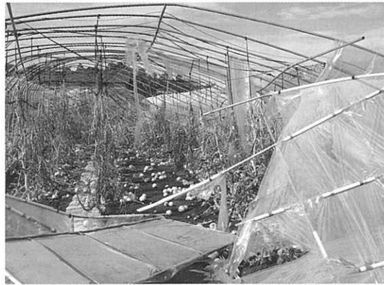
被害を受けたパイプハウス
