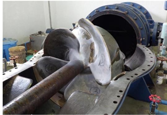
排水ポンプの機能診断 （インペラ(羽根車)の点検）
