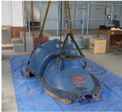
排水ポンプの機能診断 （ケーシング取り外し）
