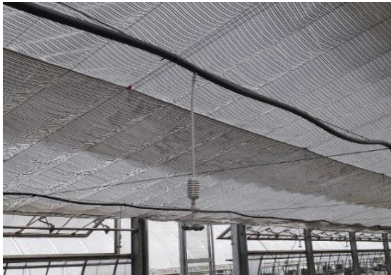
写真2 設置した簡易ミスト装置
