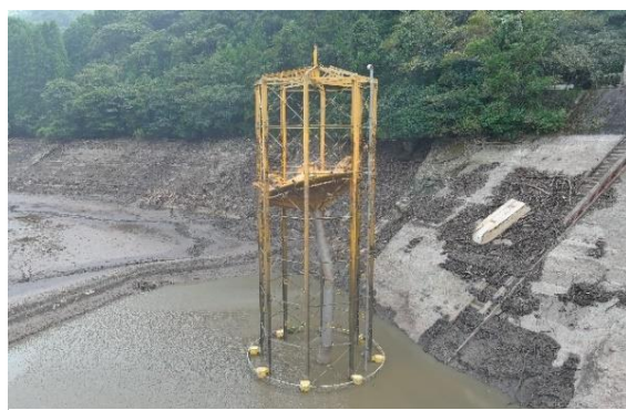
金山ダム（取水塔フロートの傾き）
